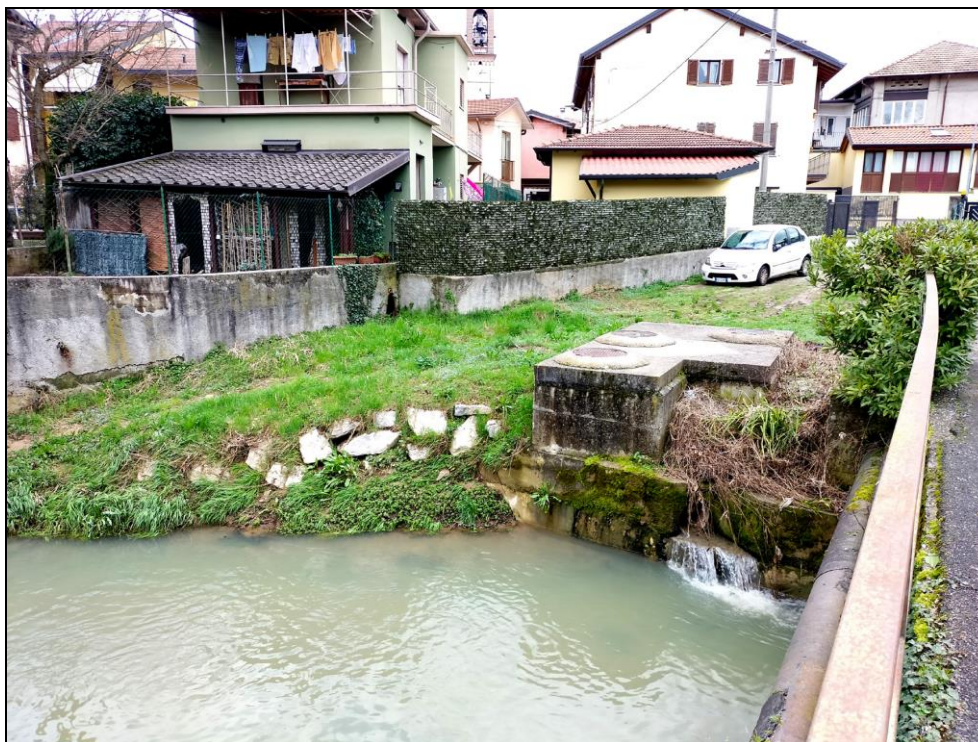
Fig. 13.21b - Ponte di via Mercato, sponda sinistra. Area del troppo pieno del collettore. Si vede la zona oggetto di allagamenti prima dei lavori di sistemazione dell'alveo.
