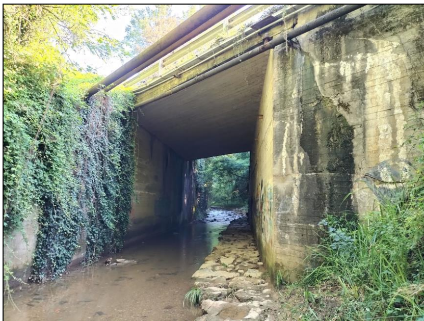
Fig. 13.10 - Dettaglio del ponte della SP 166 vista da Sud. Si notano i tubi dei servizi e la passerella pedonale lungo il greto del torrente (punto da cui è stata misurata l'altezza del ponte)
