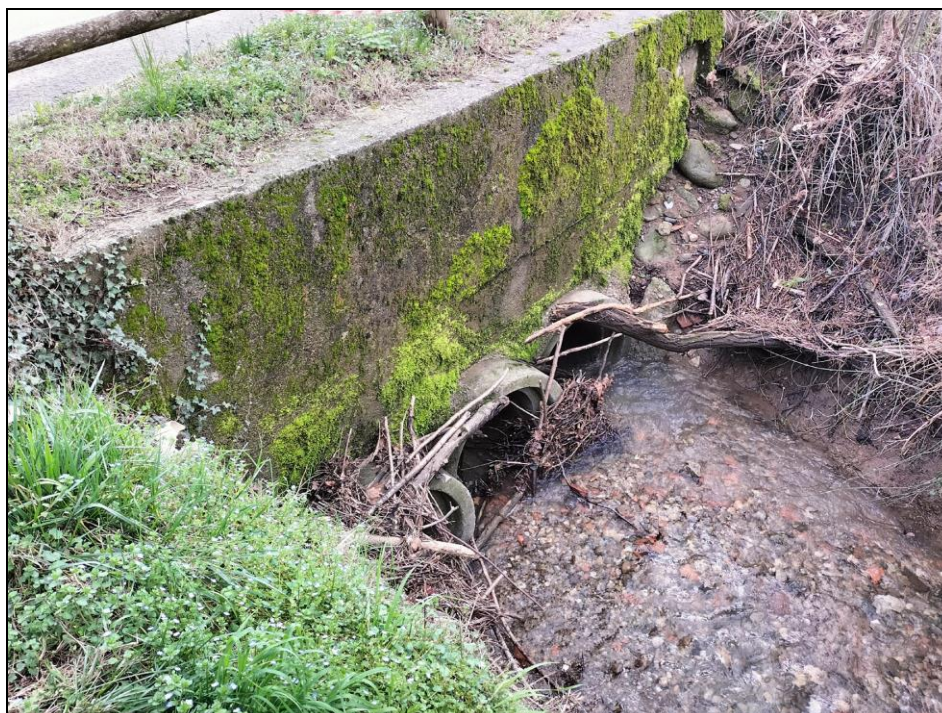
Fig. 13.31b - Attraversamento di via delle Castagne del torrente Luf, appena prima dell'immissione nel t. Buliga. Vista da monte verso valle, il giorno 11/03/24 successivamente ad un evento piovoso. Si nota la parziale ostruzione dei tubi e il materiale portato in alveo.
